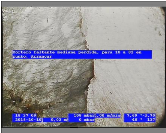
Foto: 4_5A 0,03m, Mortero faltante mediana perdida, para 10 a 02 en punto, Arrancar / Se recomienda realizar la reparación puntual
