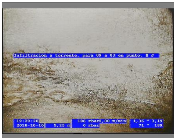
Foto: 6_7A 5,25m, Infiltración a torrente, para 09 a 03 en punto, # J / Se recomienda realizar la reparación puntual
