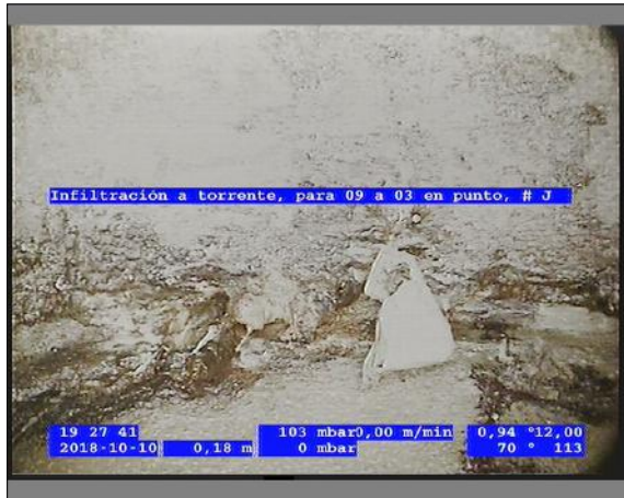
Foto: 6_5A 0,18m, Infiltración a torrente, para 09 a 03 en punto, # J / Se recomienda realizar la reparación puntual
