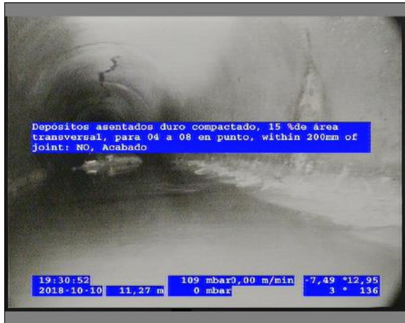
Foto: 6_9A 11,27m, Depósitos asentados duro compactado, 15 %de área transversal, para 04 a 08 en punto, within 200mm of joint: NO, Acabado / Se recomienda la limpieza
