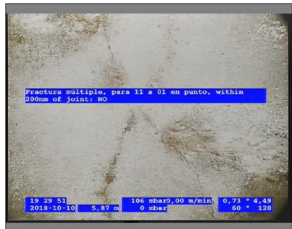
Foto: 6_8A 5,87m, Fractura múltiple, para 11 a 01 en punto, within 200mm of joint: NO / Se recomienda realizar la reparación puntual
