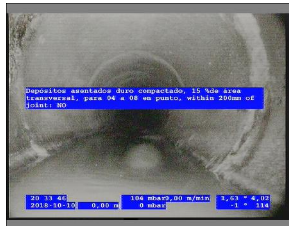
Foto: 9_4A 0m, Depósitos asentados duro compactado, 15 %de área transversal, para 04 a 08 en punto, within 200mm of joint: NO, Arrancar / Se recomienda la limpieza
