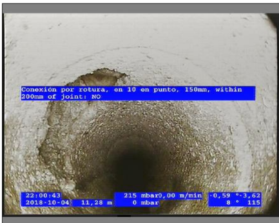
Foto: 1_8A 11,85m, Conexión por rotura, en 10 en punto, 150mm, within 200mm of joint: NO / Ninguna, dentro de los parámetros admisibles
