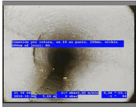
Foto: 1_5A 6,47m, Conexión por rotura, en 10 en punto, 150mm, within 200mm of joint: NO / Ninguna, dentro de los parámetros admisibles
