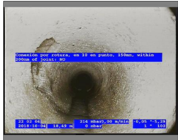
Foto: 1_10A 19,09m, Conexión por rotura, en 10 en punto, 150mm, within 200mm of joint: NO / Ninguna, dentro de los parámetros admisibles
