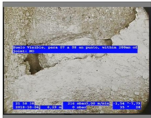
Foto: 1_6A 6,47m, Suelo Visible, para 07 a 08 en punto, within 200mm of joint: NO / Se recomienda realizar la reparacion puntual
