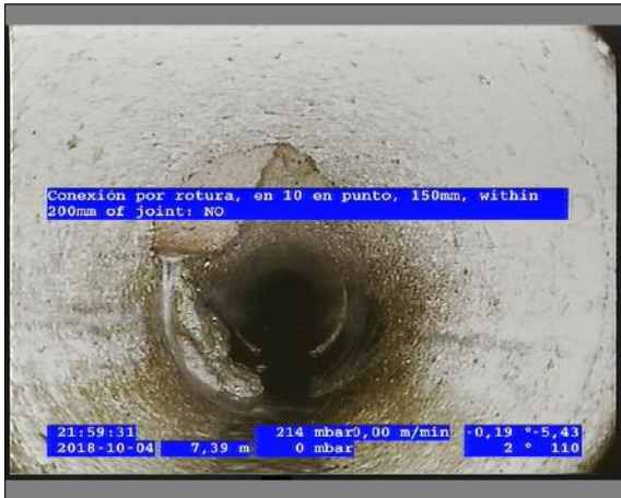
Foto: 1_7A 8,13m, Conexión por rotura, en 10 en punto, 150mm, within 200mm of joint: NO / Ninguna, dentro de los parámetros admisibles
