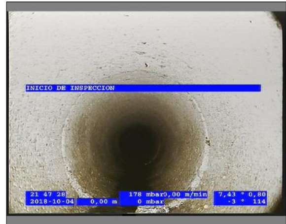
Foto: 1_2A 0m, INICIO DE INSPECCION / Ninguna, dentro de los parámetros admisibles
