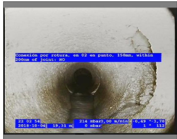
Foto: 1_11A 19,31m, Conexión por rotura, en 02 en punto, 150mm, within 200mm of joint: NO / Ninguna, dentro de los parámetros admisibles
