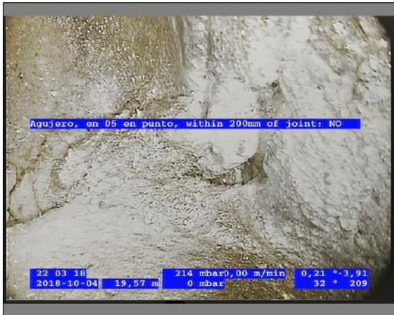
Foto: 1_12A 19,8m, Agujero, en 05 en punto, within 200mm of joint: NO / Se recomienda realizar la reparacion puntual
