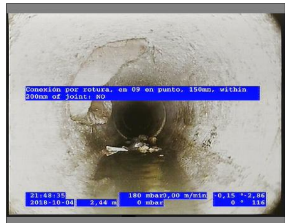
Foto: 1_4A 3,08m, Conexión por rotura, en 09 en punto, 150mm, within 200mm of joint: NO / Ninguna, dentro de los parámetros admisibles
