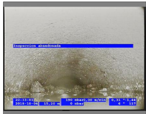
Foto: 2_8A 15,2m, Inspeccion abandonada, por depósitos 75% / Se recomienda la limpieza
