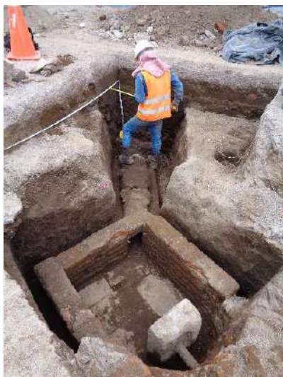
Foto 90 Ducto cajón y Caja de sedimentación
