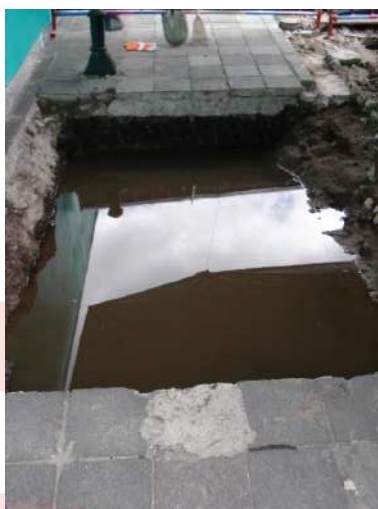
Foto 102 Unidad 27 Detalle de unidad luego de lluvia
