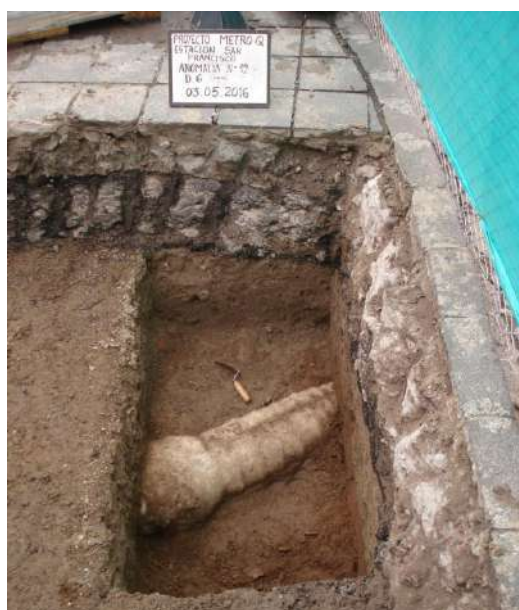
Foto 105 Unidad 28 detalle de tubería
