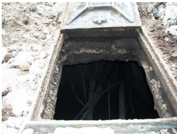
Foto 31 Detalle de ducto para fibra óptica.
